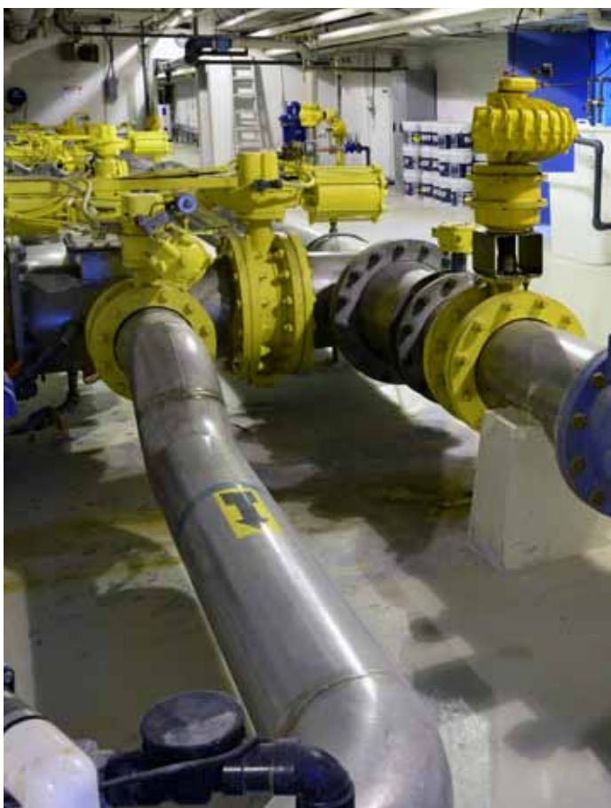
Conduite de l'usine de filtration de Chicoutimi
