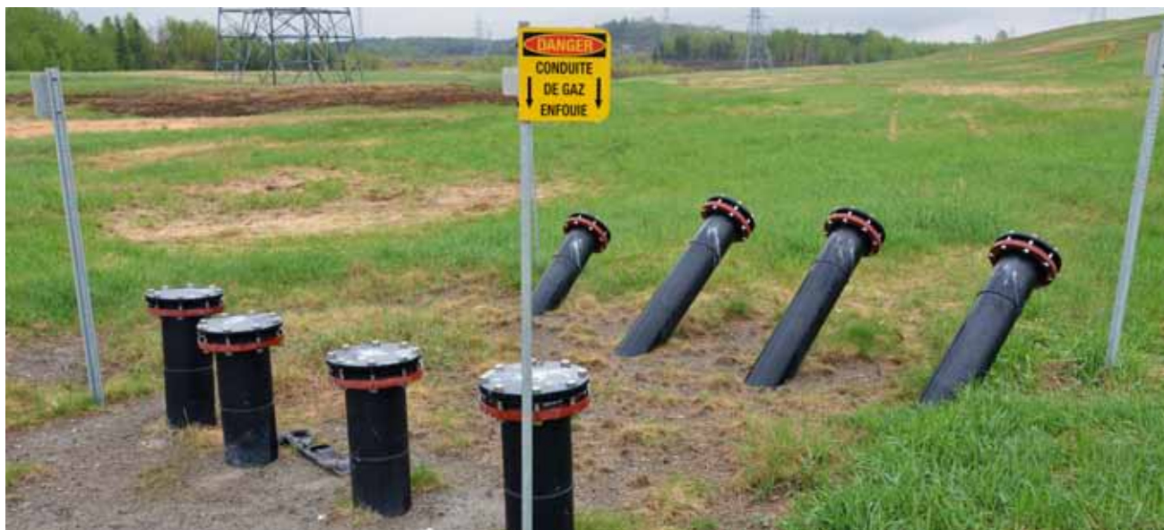
Réseau de conduites de captage des biogaz de l'ancien lieu d'enfouissement sanitaire de Laterrière
