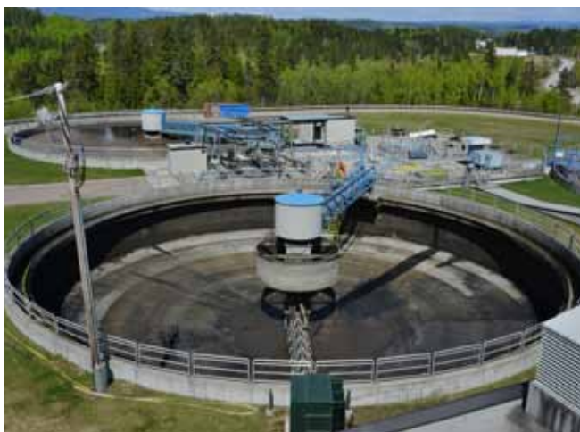
Décanteur – Usine d'épuration des eaux usées
