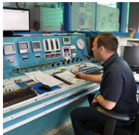
Contrôle du traitement des eaux usées
