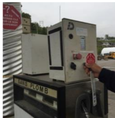
Photo 2 : Boîte du système de contrôle d'accès installée sur la pompe
