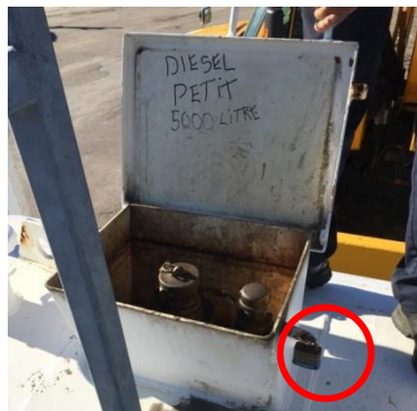
Photo 7 Cadenas barré sur lui-même; bouchon et couvercle non sécurisés
