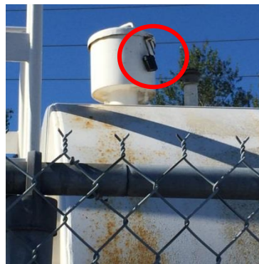
Photo 8 : Cadenas non barré; bouchon et couvercle non sécurisés
