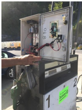
Photo 3 : Accès manuel à l'intérieur des boîtes du système de contrôle d'accès
