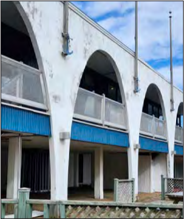
417. Arches de la façade et état du crépi, 2024
