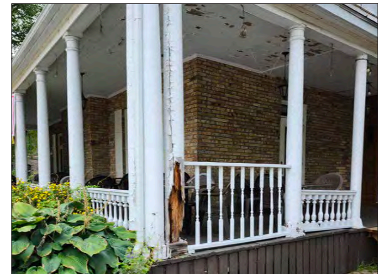
403. État des colonnes et écaillage de la peinture, 2024
