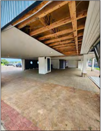
418. État du plafond, 2024
