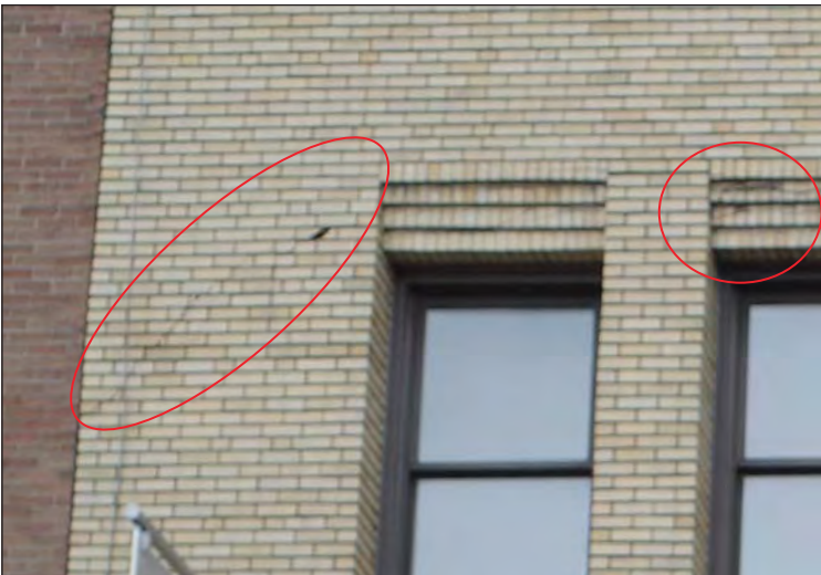
356. Fissures dans la maçonnerie de la façade, 2024
