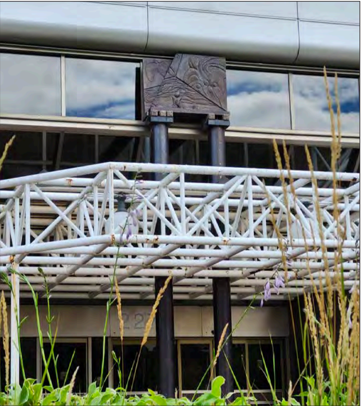
297. Corrosion de la marquise, 2024
