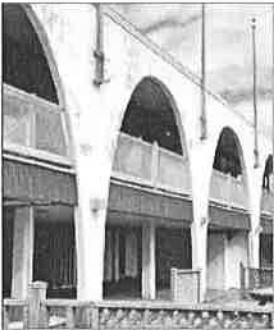
417. Arches de la façade et état du crépi, 2024
