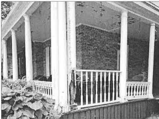
403. État des colonnes et écaillage de la peinture, 2024
