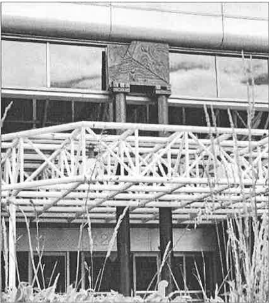
297. Corrosion de la marquise, 2024
