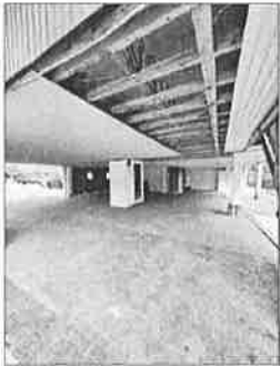
418. État du plafond, 2024
