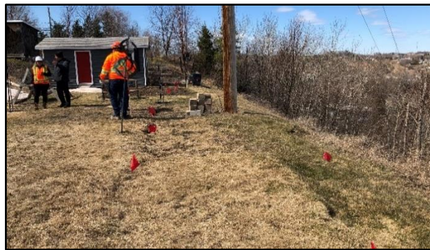
Figure 2. Suivi de la fissure de 60 m observée en sommet de talus sur l'avenue du Parc à La Baie.
