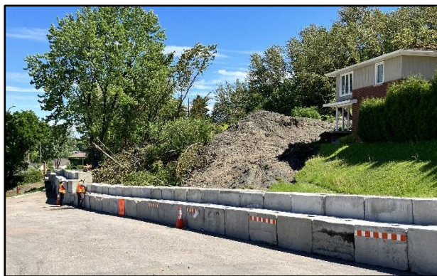
Figure 3. Surveillance des conditions de stabilité du talus à la suite du glissement de terrain.
